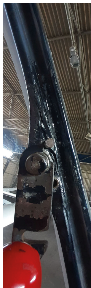
Fot. 7 Jantar 2B jeszcze bardziej uszkodzony zamek (mat. autora)
