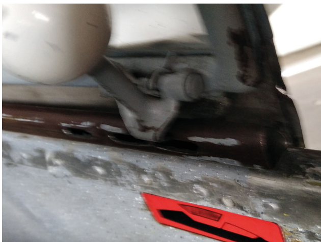
Fot. 3 Wyeksploatowana prowadnica - wyrobione otwory. (mat. autora)
